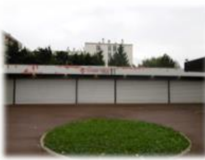
Enseigne en mauvais état et non adaptée à la façade commerciale?
