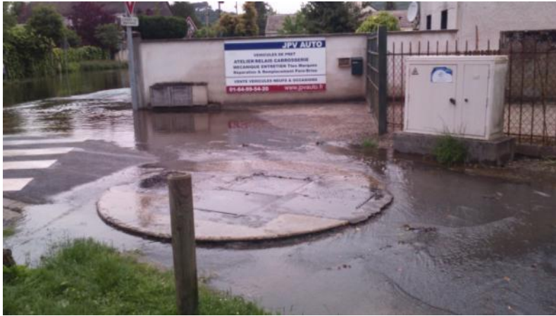
Figure 23 : Poste de l'île Amet à Maise (arrêt complet et armoire touchée)
