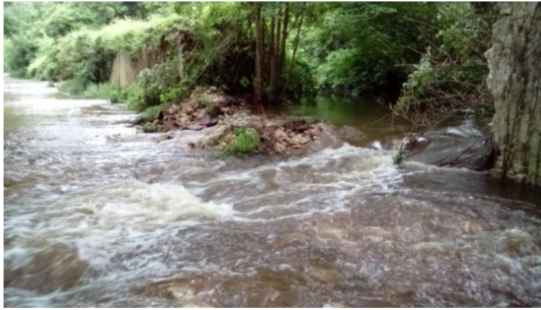
Figure 1 : brèche dans un mur en pierre au niveau du golf d'Augerville
