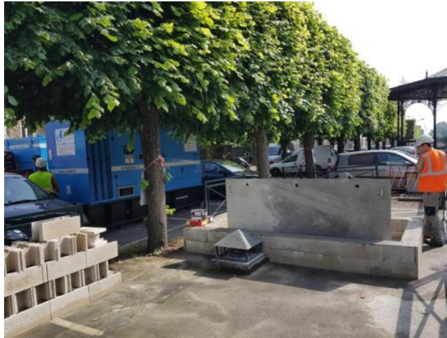
Figure 40 : Poste Aristide Briand à Corbeil-Essonnes (non impacté mais protection de l'armoire et groupe électrogène amené en prévision)
