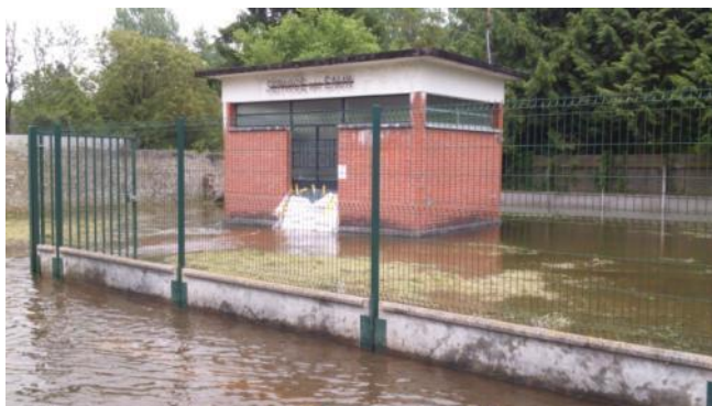
Figure 17 : forage de Gironville (arrêt complet et pollution par l'Essonne)
