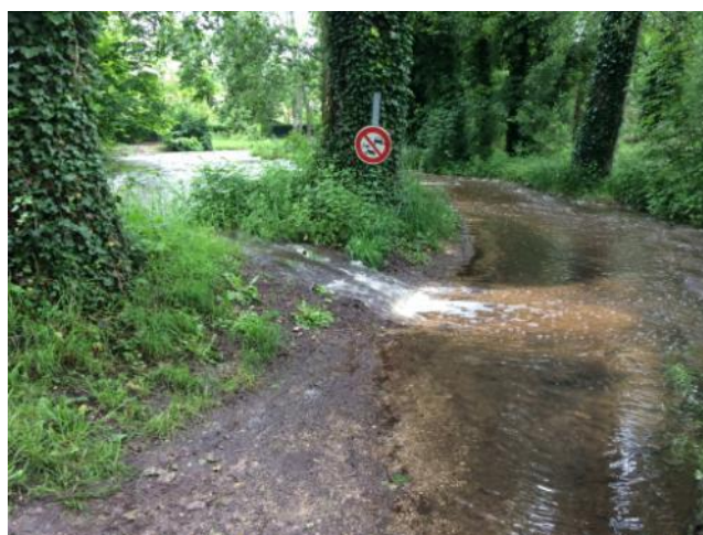
Figure 20 : une des nombreuses brèches qui se sont formées dans la digue droite du bras du moulin de Vicq à Gironville-sur-Essonne
