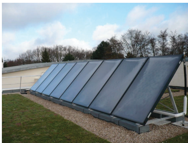
Panneaux solaires thermiques plan en toiture terrasse. Source TRANS-FAIRE
