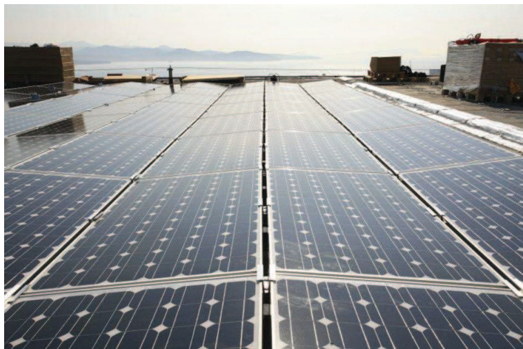
Panneaux photovoltaïques en toiture terrasse
